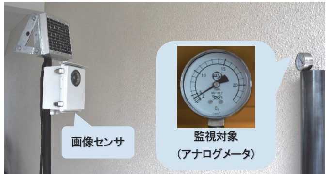
アナログメータ監視の例 Example of monitoring analog meter
