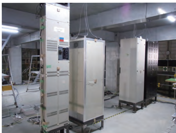
5階 多重無線通信装置, 標準ラック, 19インチラック, サーバラック
