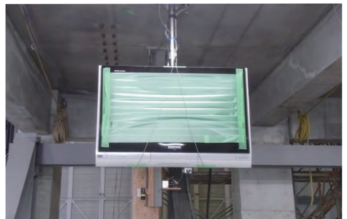
1階 天吊モニタ（画像の飛散防止措置後）
