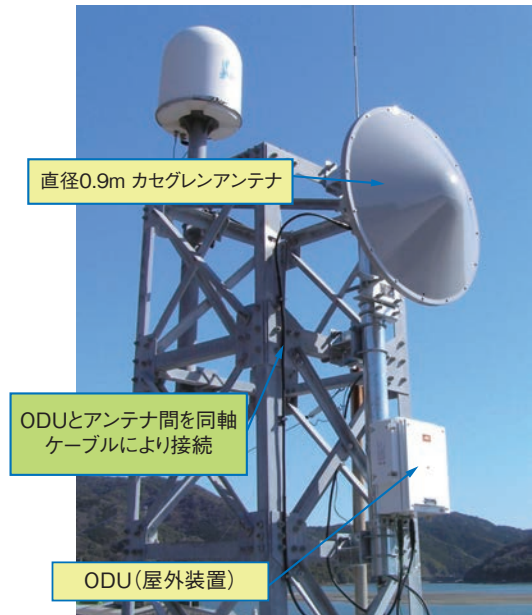
屋外装置の屋外設置例
