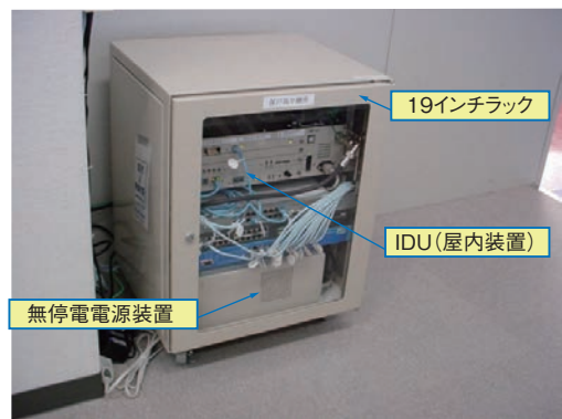
屋内装置の室内設置例 (他の設備と一緒にラック実装)
