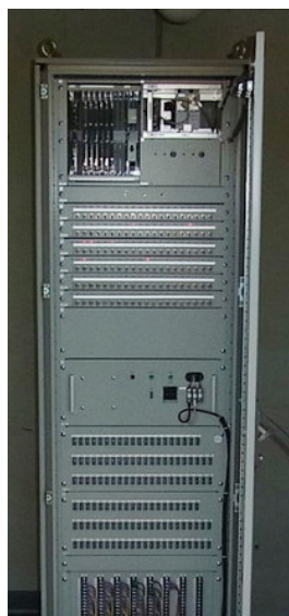
図5 中継装置 Fig.5 Relay unit
