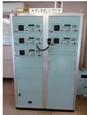
国際VHF通信設備 VHF Communication System
