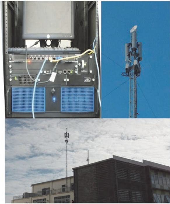
図8 コアネットワークシステムとアンテナ・基地局の設置運用例
