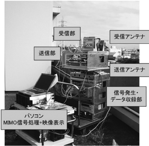
図9 機能試作機 設置状況
