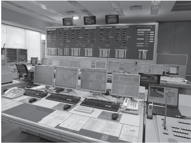
図2 システム設置例 (越戸土木管理所)
