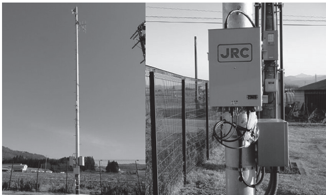
図2 バイオマス資源化センターに設置した基地局装置
