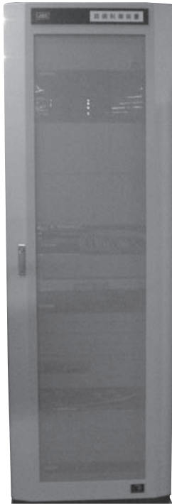
図3 路側制御装置外観
