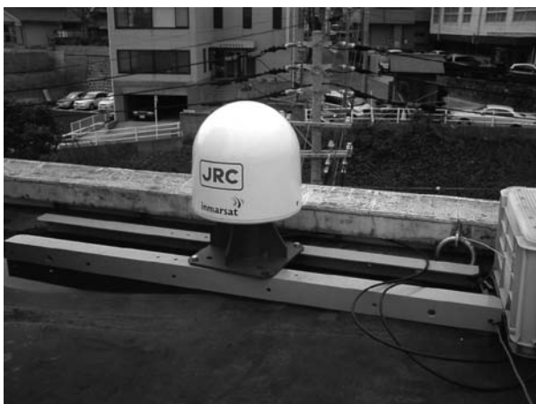
図2 長崎支店屋上の船上装置仮設置状況
