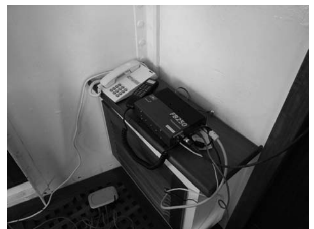
図5 実船評価時船内装置設置状況
