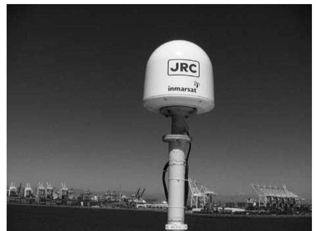
図4 実船評価時船上装置設置状況
