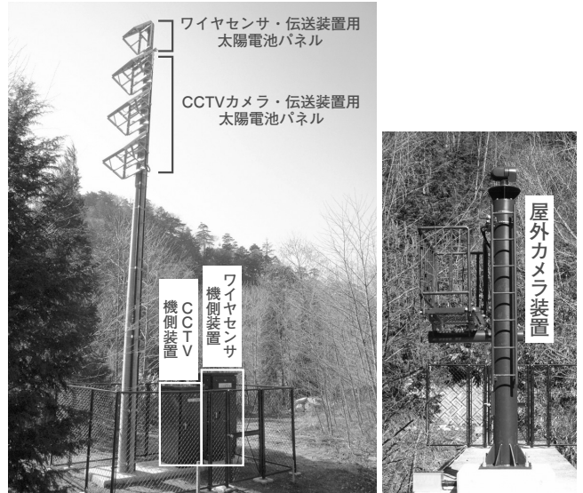
太陽電池パネル, CCTV機側装置 および 屋外カメラ Solar Panel, CCTV Equipment and Outdoor Camera Unit
