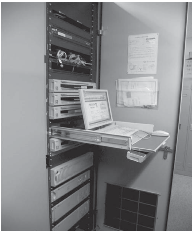
写真1 県庁監視局に設置された処理設備
