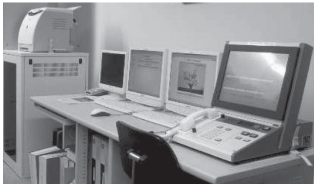
図4-6 統制局設備 (一部) 右から統制台, データ通信サーバ, 運用管理装置 FAXサーバ
